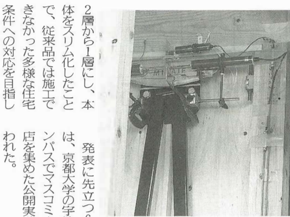
MIRAI E S設置部
